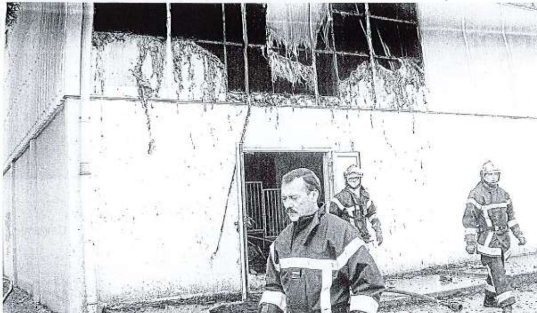
Brioux-sur-Boutonne, hier. L'incendie a détruit la salle des sports. Un court-circuit serait à l'origine du sinistre. Photo CO - Lucien BRAIN.
